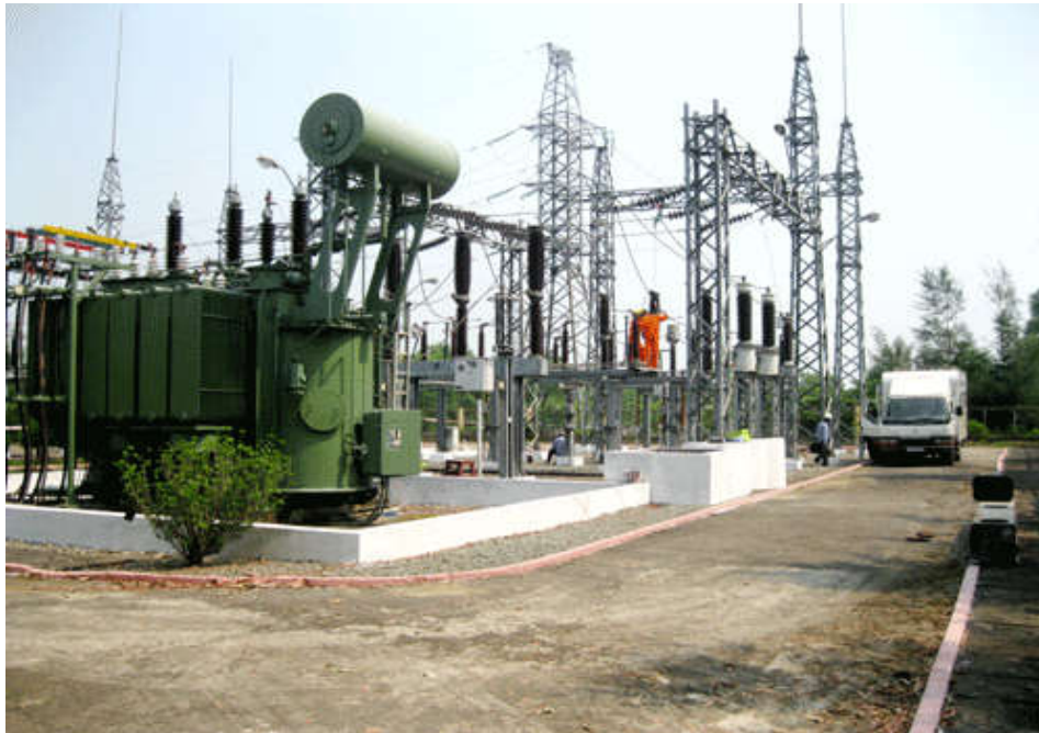
Hình 23: Hiện trạng hệ thống cấp điện.
